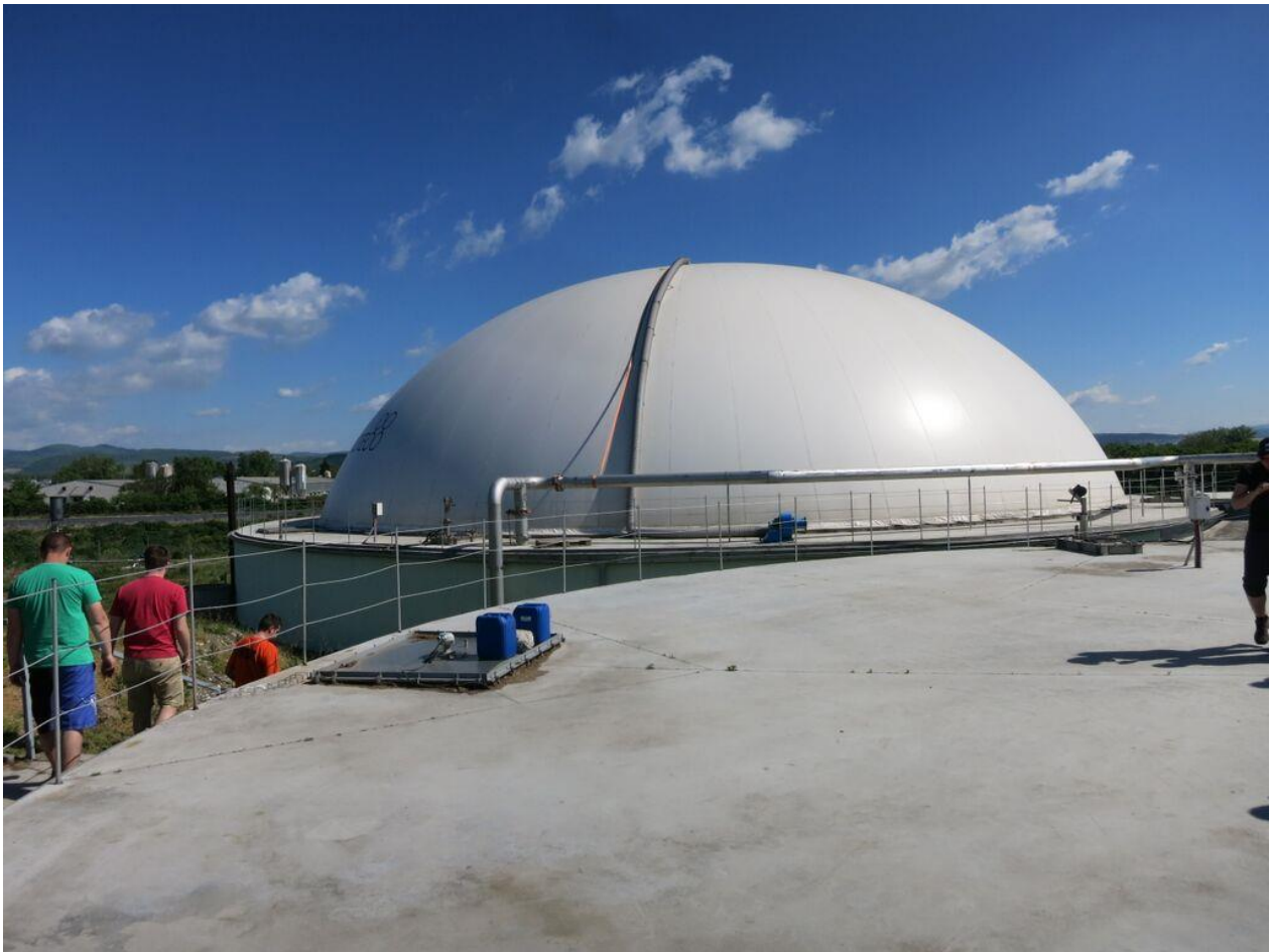
Bioplynová stanice Velké Bírovce
